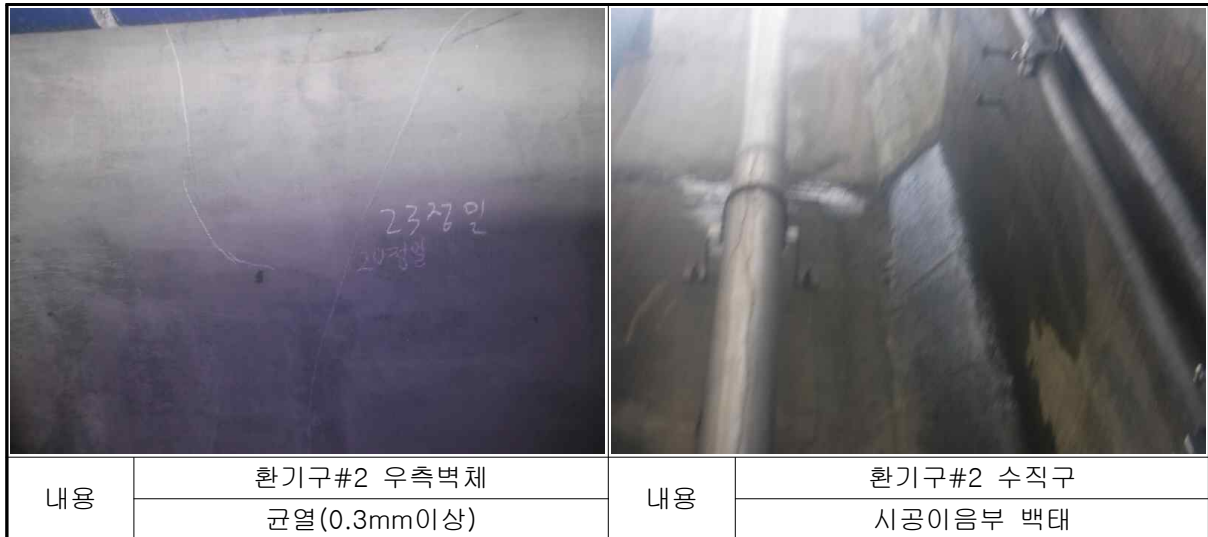
【사진 12.3】 호수인출 전력구 터널 주요 손상
